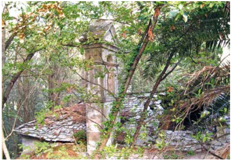
Parti di campanile e di tetto parzialmente crollato della chiesetta viste da una strada soprastante.
